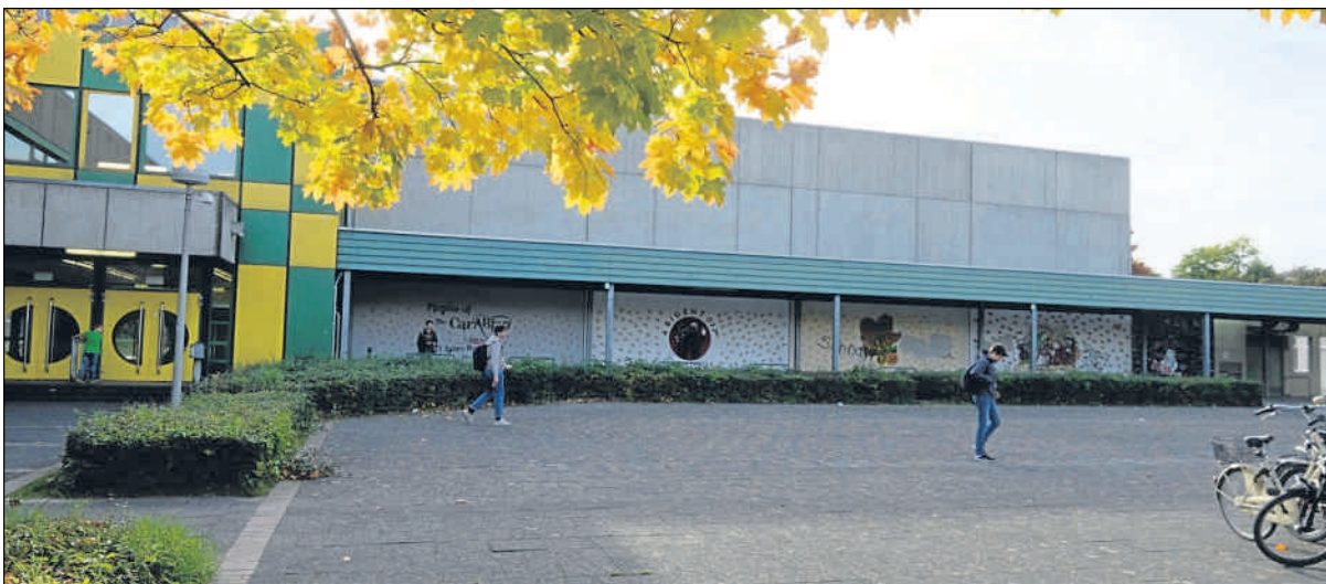
In keinem guten Zustand ist die Turnhalle der Europaschule. Rund fünf Millionen Euro würde eine Sanierung kosten, energetische Maßnahmen nicht eingerechnet.
